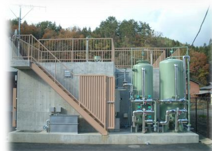
排水処理設備
