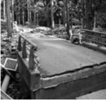
寸断された若松寺へ向かう道路
