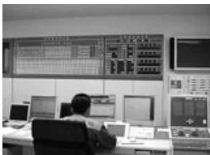
17年2月から稼働の消防指令センター
