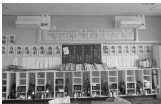
▲順次更新される空調設備
