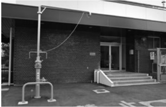
▲高掬水源地の給水設備
