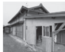
▲空き家となった住宅
